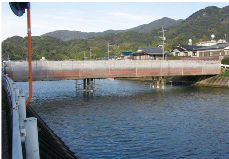
▲修繕中の新浦橋（橋長：43 m、架設年：昭和40年）。架設から47年が経過。
