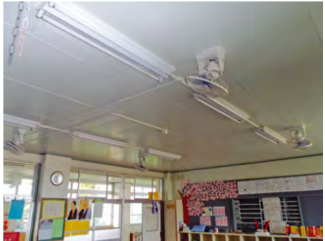
大村市内の小学校に設置されている扇風機
