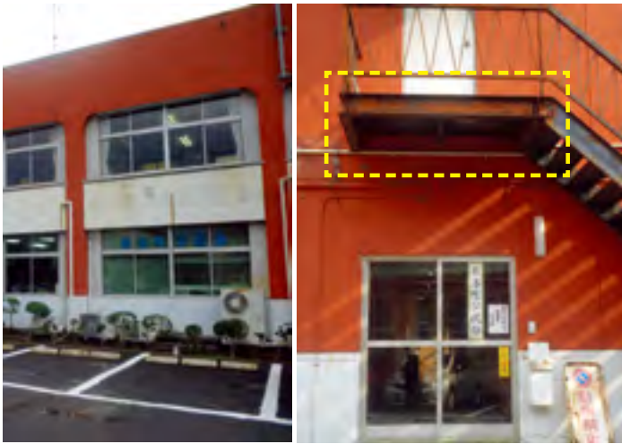
耐震は大丈夫か？ さびついた階段 早めの建て替えを！
