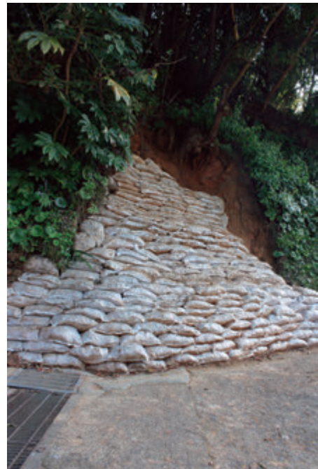
応急処置をした崖くずれ跡
