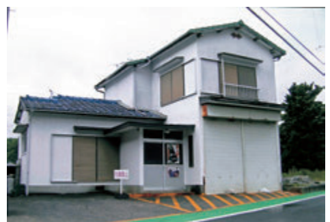
築約40年 改築が急がれる(9分団格納庫)
