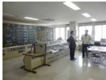
浄化センター制御室
