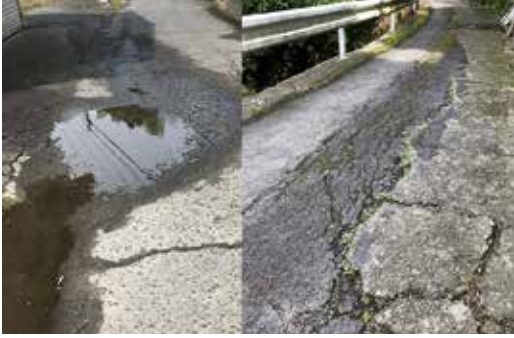
水たまり・道路の路面が凸凹の町道
