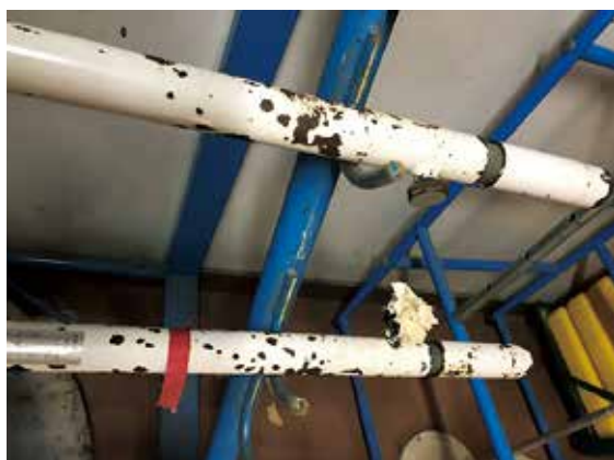
体育用具の点検も・・・古くなった支柱
