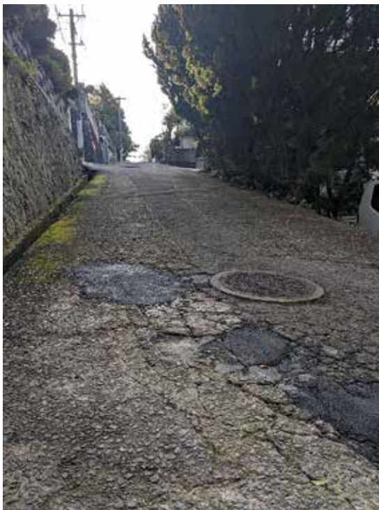
劣化が進んだ私道
