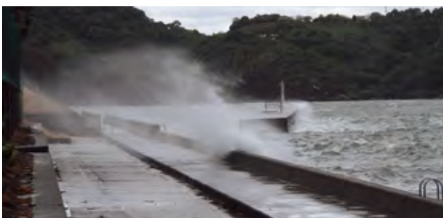
恒久的な越波対策が待たれるふれあい広場北側岸壁
