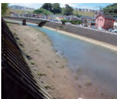
皆前橋下流付近の堆積状況
