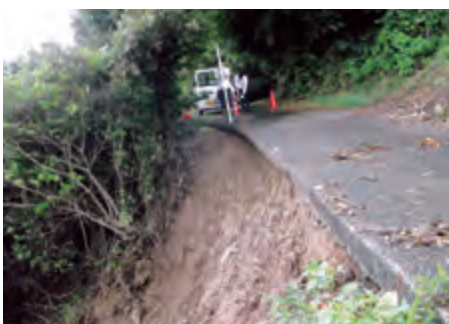
大雨でがけ崩れ 南田川内・本川内線
