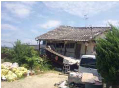
想像を絶する被害状況 (1階部分が崩壊したアパート)
