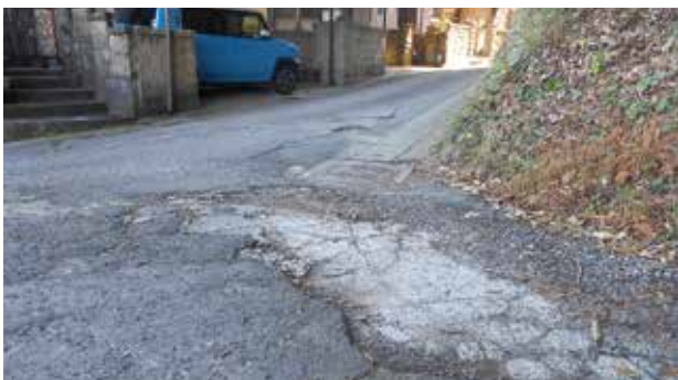
改修が急がれる道路
