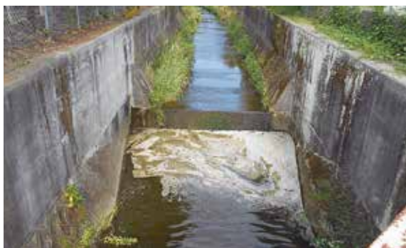
原因の調査を行うとされた泡が立った状態の南田川内川
