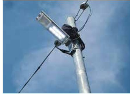
LED化された防犯灯
