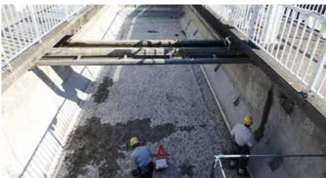
耐用年数を過ぎた設備を更新（長与浄化センター）
