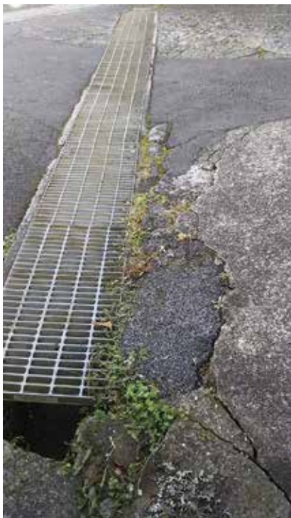
補修がされないままの私道の路面状況
