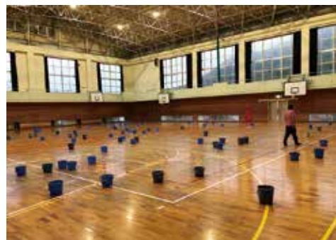
雨漏りに大量のバケツで対応 (長与南小体育館)
