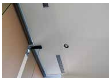
▲町民文化ホール ホワイエ雨漏改修 (令和元年度)
