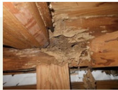
◀1階天井 シロアリ被害
