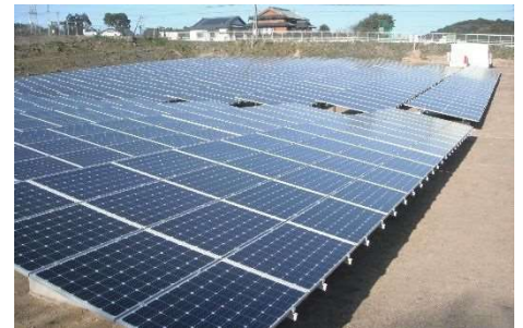
写真：ながさきソーラーネットプロジェクト〔メガ〕三京発電所
