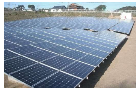
写真 ながさきソーラーネットプロジェクト〔メガ〕三京発電所
