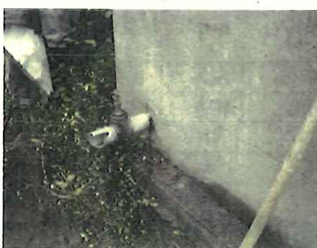
②. 防油堤のひび割れとバルブ
