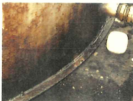
①. 重油タンクの腐食
