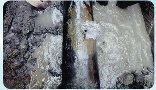
水道管からの漏水の様子
