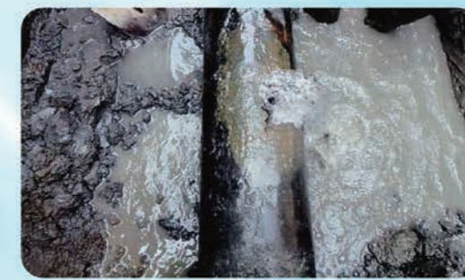
水道管からの漏水の様子
