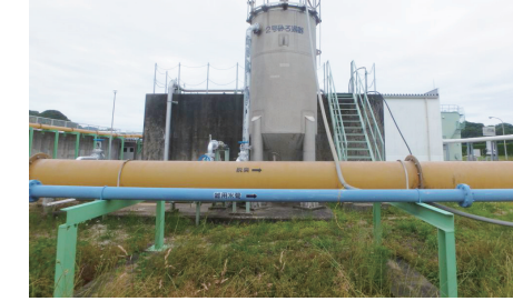
12 処理水再利用施設 (砂ろ過設備)
